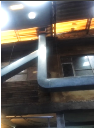
FOTOGRAFÍA 5. UNIÓN DE DUCTOS
